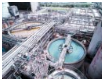
南地区排水処理設備
