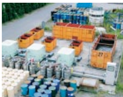
土壌浄化設備
