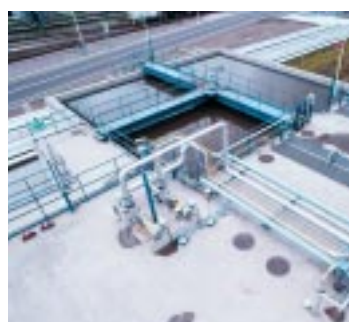
北地区排水処理設備
