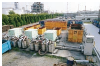
土壌浄化設備
