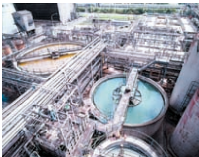
南地区排水処理設備
