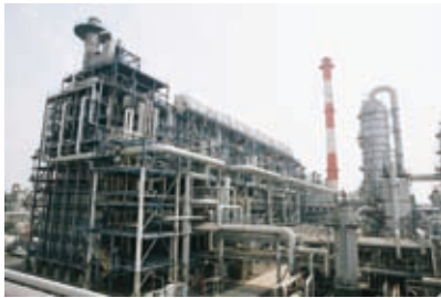
千葉工場のエチレンプラント
