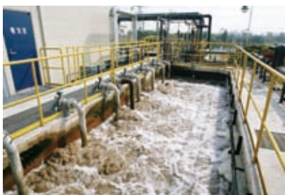
北地区排水処理設備
