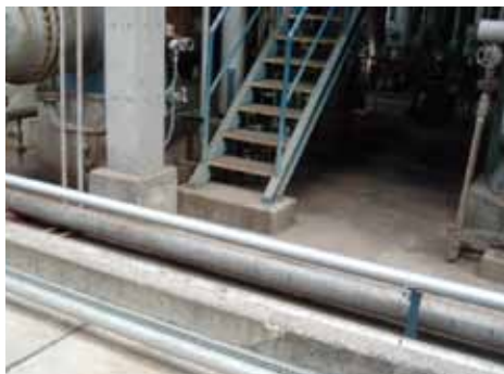
階段の降口に支柱や、配管、障壁があり激突または転倒のリスクあり
