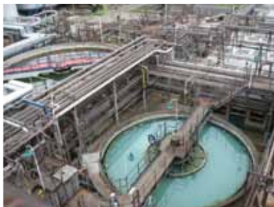
総合排水処理設備(千葉工場)
