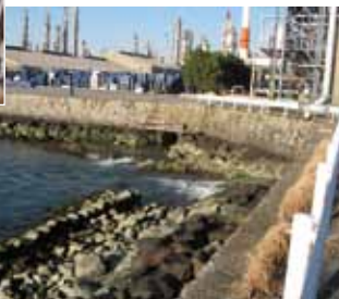
総合排水放流口(千葉工場)
