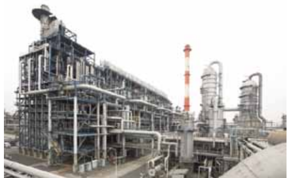
第4エチレン製造装置
