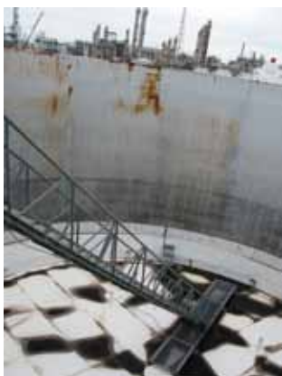
浮き屋根式タンク (フローティング・ルーフ・タンク)
