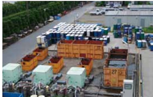
地下水揚水曝気処理施設
