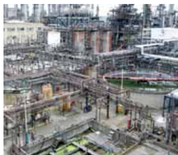
総合排水処理設備（千葉工場）
