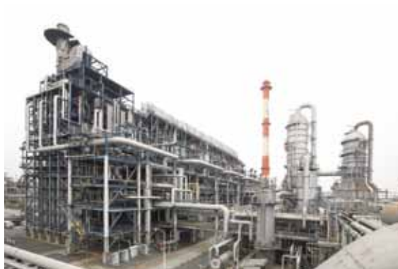
第4エチレン製造装置
