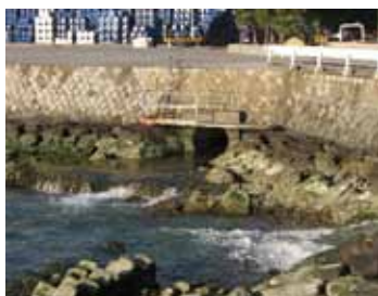
総合排水放流口（千葉工場）
