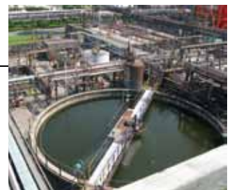
総合排水処理設備(千葉工場)
