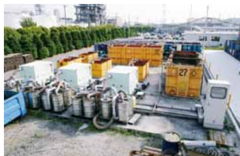
地下水浄化処理施設
