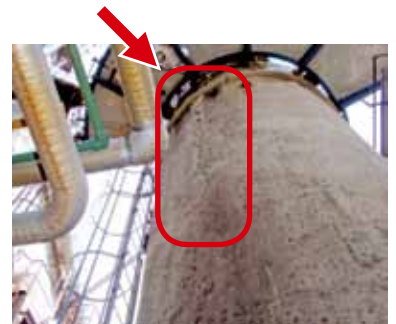
タワースカート部のひび割れ
