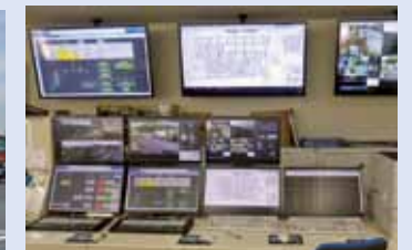
防災監視システム
