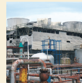
台風15号の暴風により破損した冷水塔
