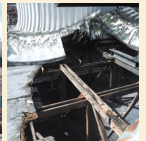
上部の破損状況
