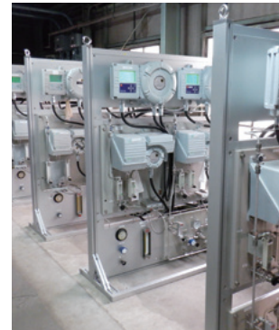
反応器監視強化のため増設した酸素計 (千葉工場・酸化エチレン製造課)
