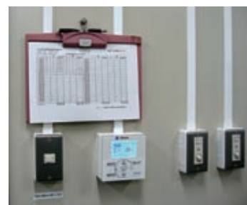
2013年7月 千葉工場 製造部署の節電・消灯実施事例
