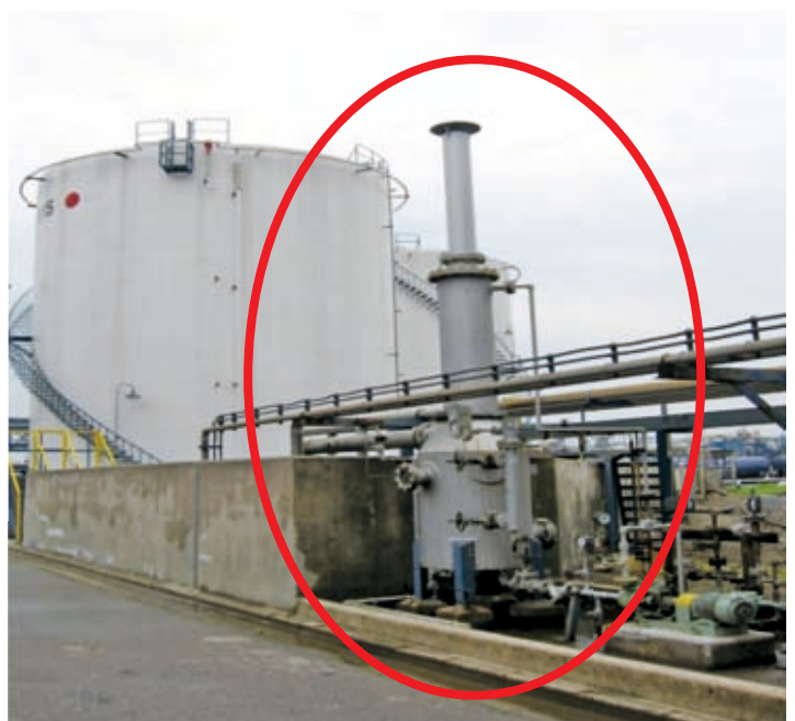
VOC排出削減対策の製品のメチルエチルケトンペーパーガス水吸収装置(赤枠内)
