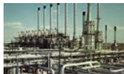
1966 第2エチレン製造装置の完成
